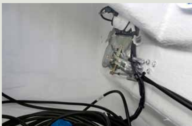
Morsekabels van de motorbediening in de bakskist zijn niet afgedekt.
