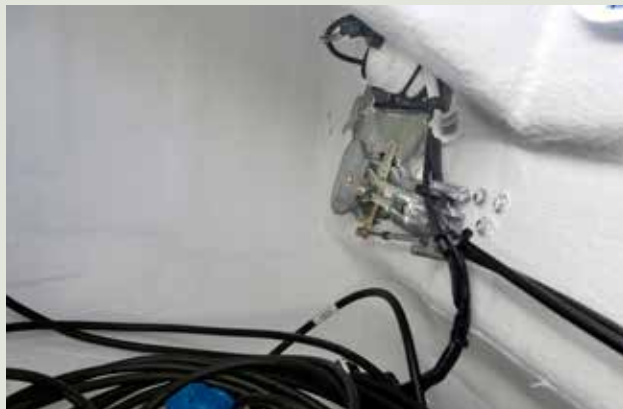
Morsekabels van de motorbediening in de balkast zijn niet afgedekt.
