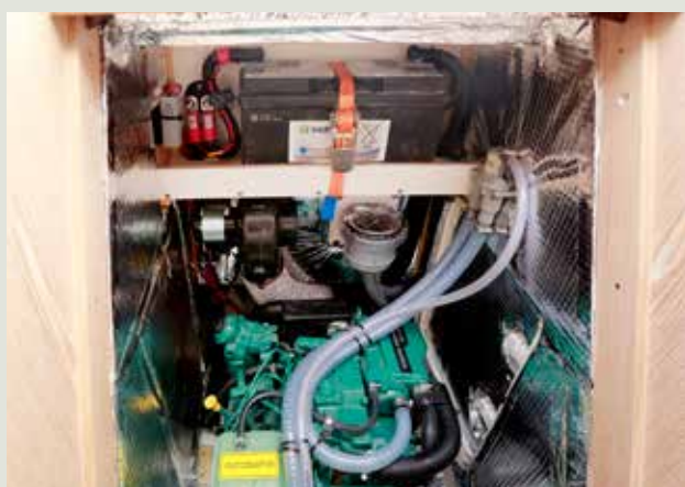
De startaccu is hoog en droog boven de motor geplaatst.
